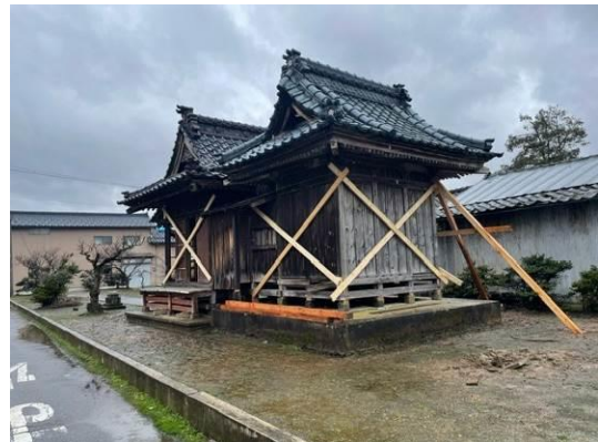
⑦西区中野小屋 崩壊寸前の神舎を木材で補強
