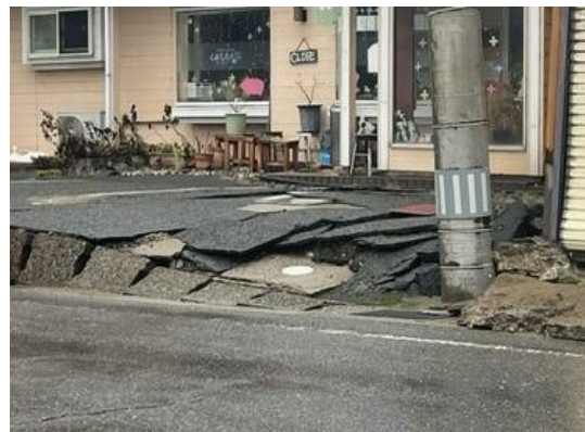
⑨西区大野 液状化により民家の駐車場が崩落
