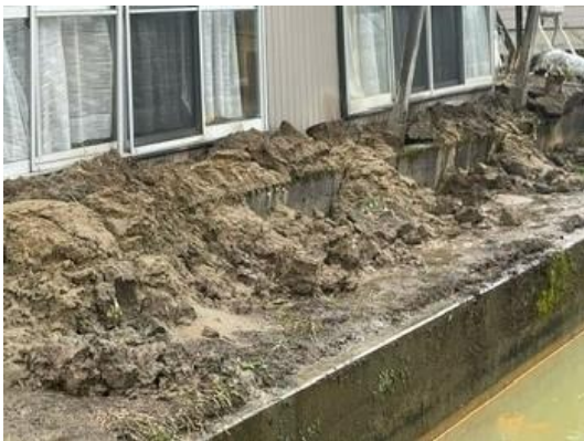
⑥西区中野小屋 住家の土台が崩落
