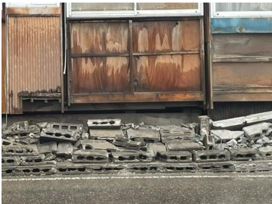
⑧西区大野 液状化によるブロック塀の倒壊
