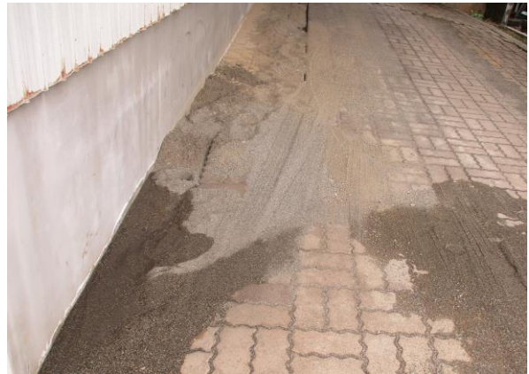
玄関前のブロックの亀裂により砂が露出
