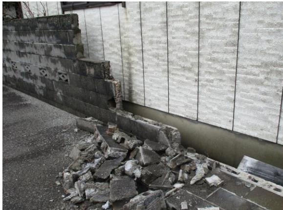
ブロック塀の倒壊
