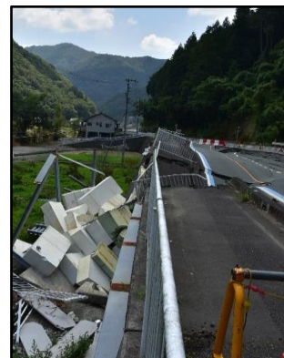
宇和川地区の道路が陥没し、片側1車線となっていた。
