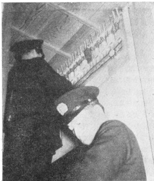
配電装置を調べる
