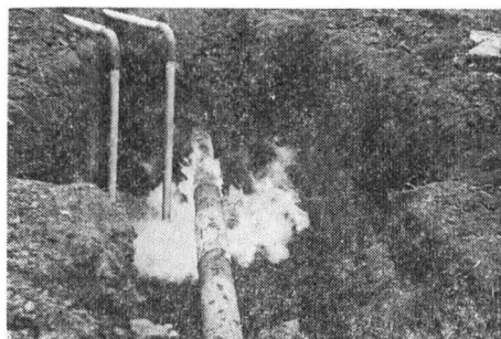
窒素ガス（40kgポンベ2本）による消火
