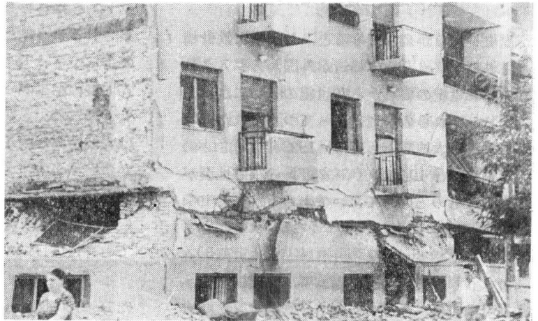
写真1 スコピエ地震におけるレンガ造建物の崩壊
