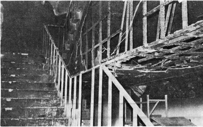
延焼経路となった階段，鉄筋耐火構造も内部は木造と同じである
