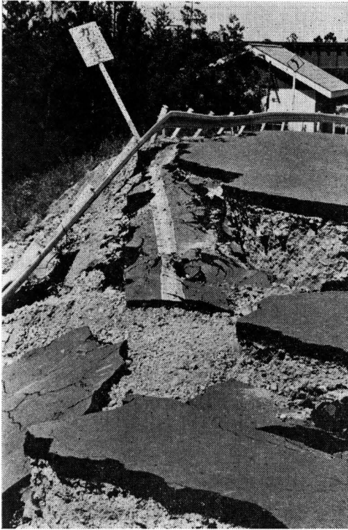
被害の多かった盛土（1968年 十勝沖地震）
