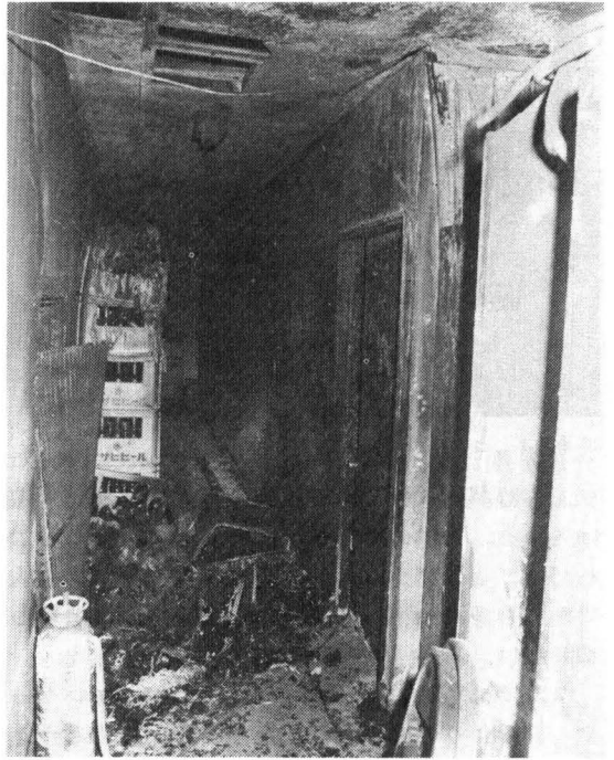
下から煙が上がってきたダクト付近
