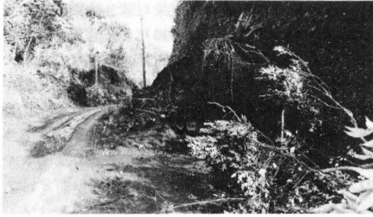
道路への土砂崩れ
