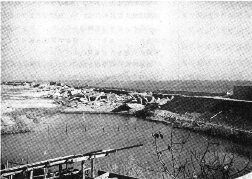
写真1 伊勢湾台風の来襲で決壊した干拓地の堤防。見える限りの堤防が無残な姿をしている。
