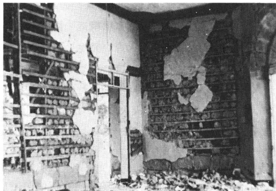
破壊したタケサル構造建物の内部
