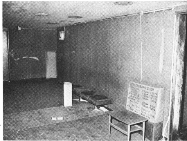
4-③ エレベーターホールから406号室をみる。壁はススで非常によごれている。右側手前に見えるのは階段室への出入口。
