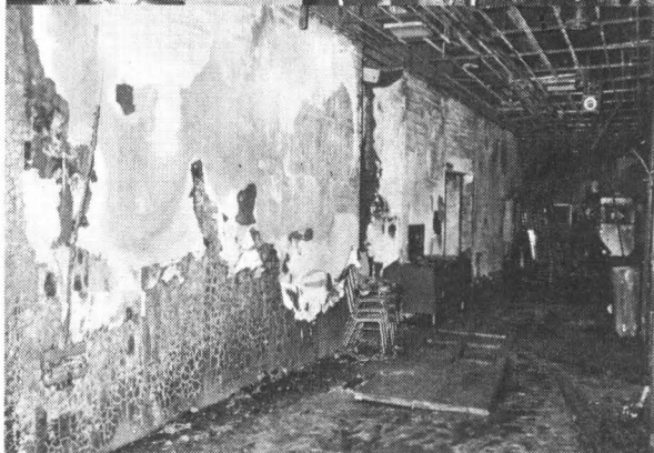
I-④ 宴会場横通路。ビニールクロス仕上壁の剥落が目立つ。
