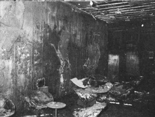
1-⑤ ロビーの焼損状況。
