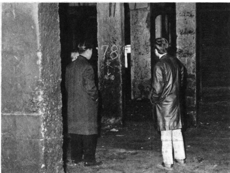
↑ 焼けたたれたコンクリート柱。7階。
