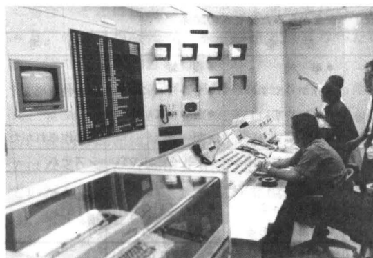
写真2 東京副都心の、ある超高層ビルの防災センター
