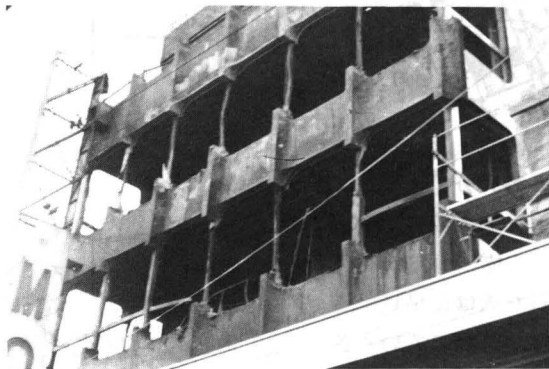
炎が吹き出した大沼デパート、中通町り沿いの窓⑤
