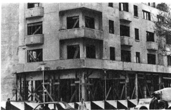
被害が大きかったピロティ式のビル
