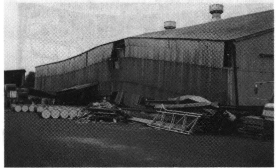
写真4 崩壊した2階建てS造倉庫
