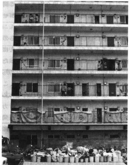
写真5 開閉不能になった玄関ドア
