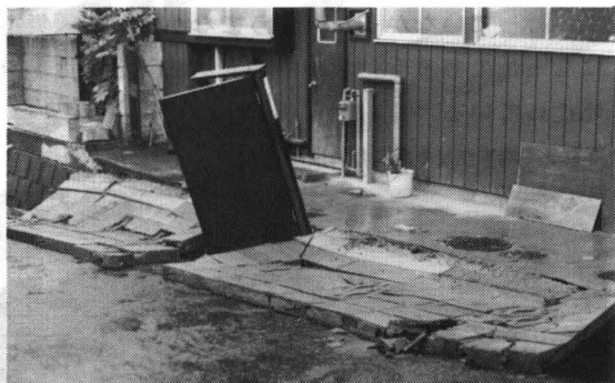
写真7 倒壊したブロック塀
