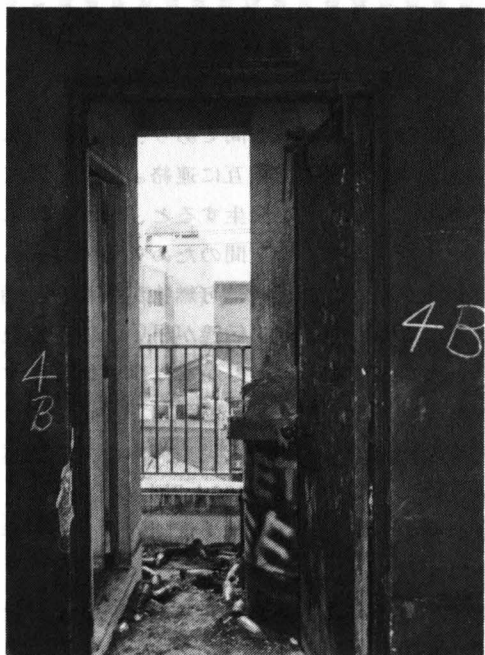
千日デパートのバルコニー付き特避難階段（せっかくの特別避難階段が使われなくて100人以上の死者を出した例）
