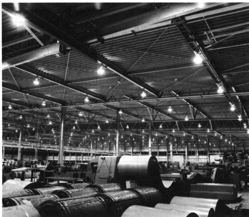
シャッター製造工場の照明：水銀ランプ
