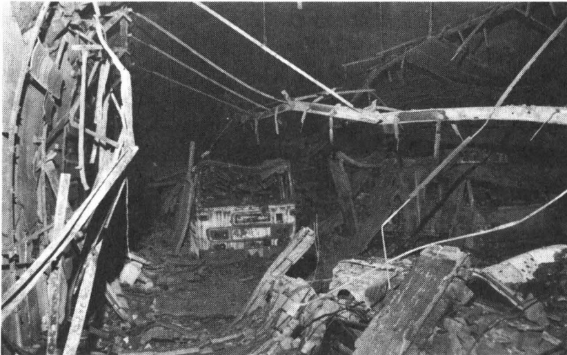
写真1 日本坂トンネルの事故
