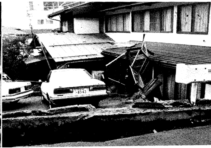
写真6 東地区の被害状況
