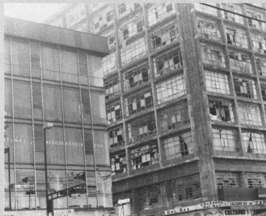
ガラス被害の違い。右のビルはスチールサッシュ硬化パテ止め、左のビルはアルミサッシュ
