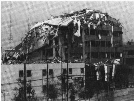
上半分が倒壊した14階建てのビル
