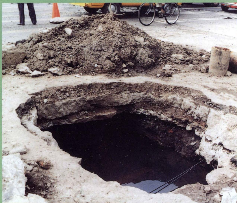
地盤沈下のため、道路をかさ上げした跡。 昔の舗装面が断面にみられる。
