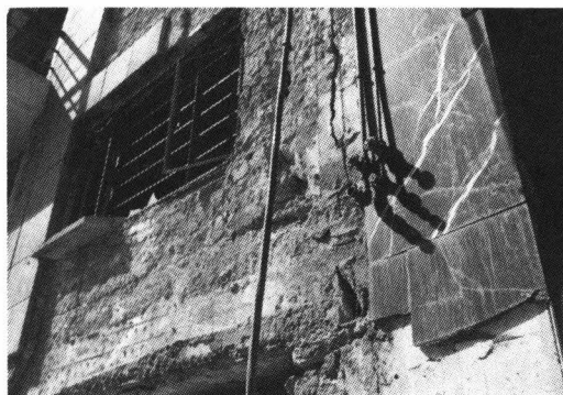
壁に取り付けられたL.P.G受入れバルブ
