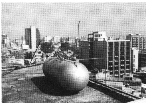
屋上に設置されたL.P.Gタンク
