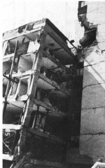
左側の9階建ての建物と右側の9階建ての建物が共振し、ぶつかり合い、左側の建物は1階～3階がつぶれており、右側の建物の6階～8階部分がひどく破壊している。
