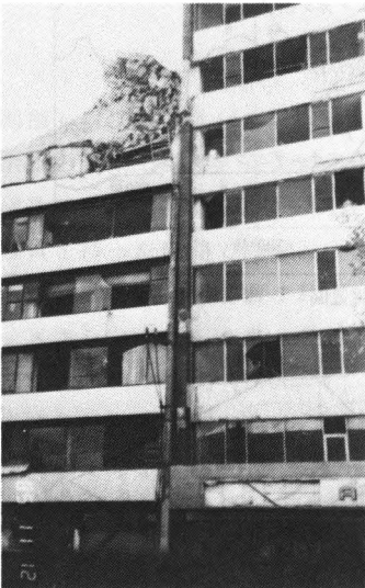
共振により、左側の建物は6階から上階が崩壊している。
