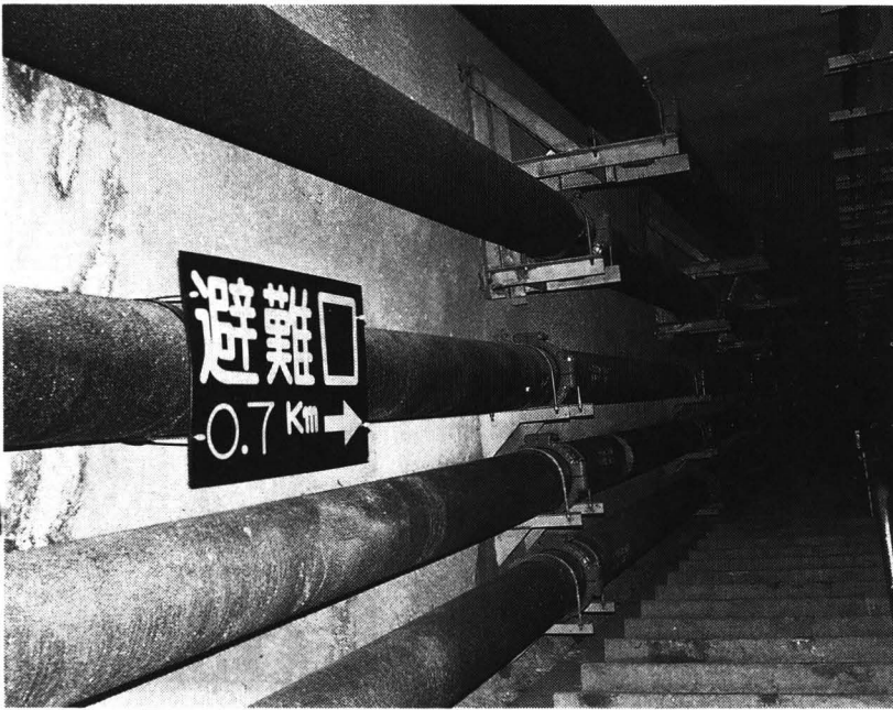
避難誘導標識。バックはトンネル内の湧水を排出するための排水管。湧水は斜坑の底に流れ集まり、そこに据えられている排水ポンプ(98t/毎分能力)により、この排水管を通して排出される。
