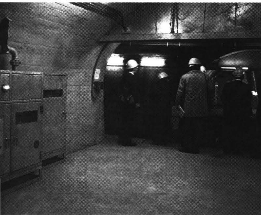
避難誘導路に設置された消火栓。
