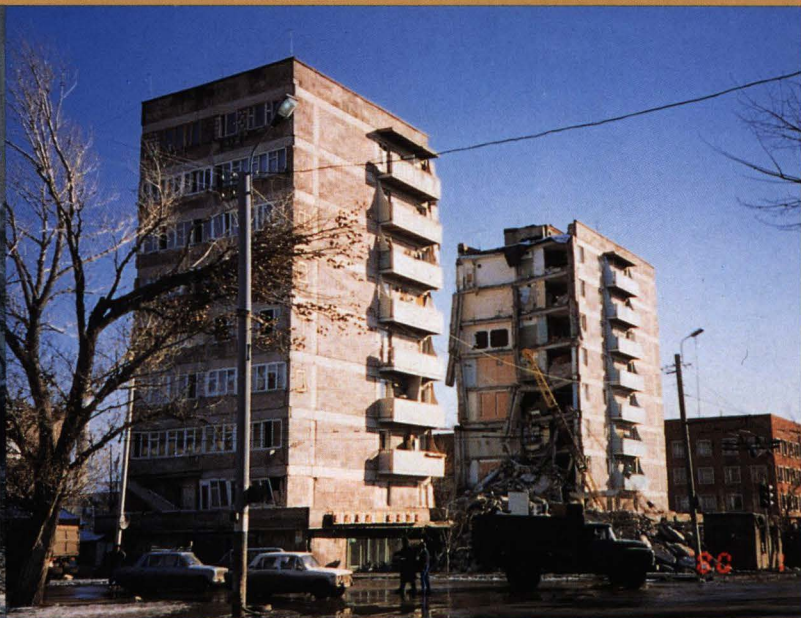
写真8：中央部が局部的に崩壊した9階建アパート。建物の一体性の弱さを示している
