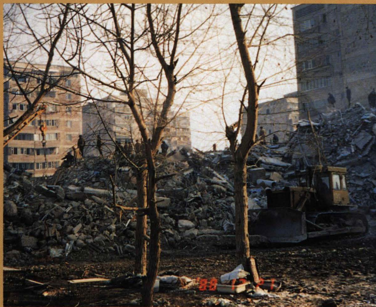
写真6：瓦礫の海と化したプレキャストラー メン構造による高層アパートの団地
