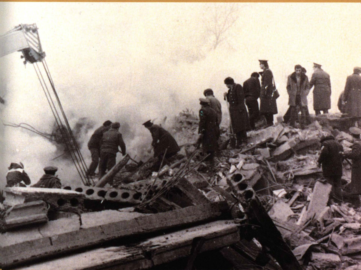
写真3：被災直後の高層アパートの崩壊状況と被害者の救助状況
