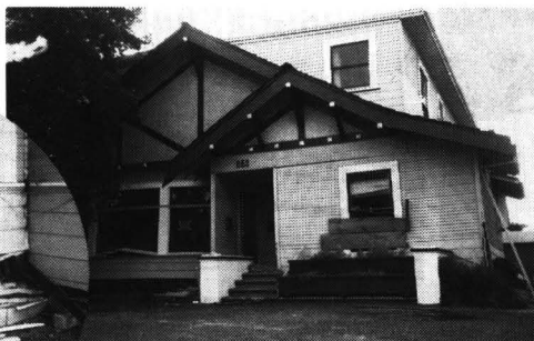
檜の部分が潰れた木造住宅（ロスガトス）
