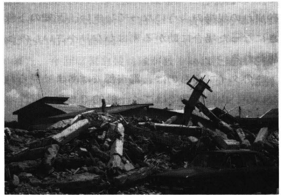
写真11 崩れたRC・レンガ造混合型の建物(ラシュト)
