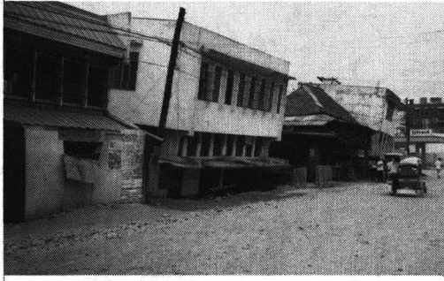
ダバオの液状化による建物の沈下 地盤が広域で液状化し、重いビルが沈んだ。旧河道で丸く囲まれた地域がひどく、まったく被害のない地域もある。
