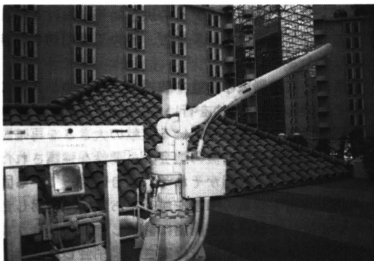
写真8 大規模空間内放水銃設置状況
