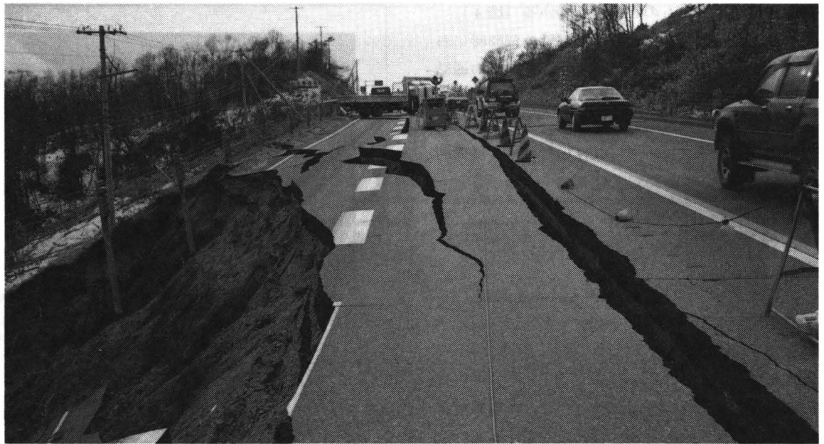
写真3 国道38号線の道路崩壊
