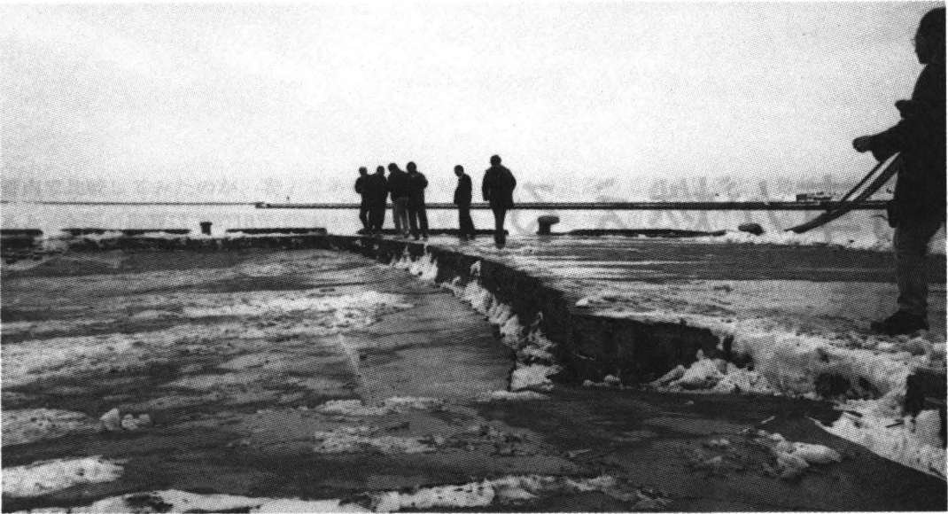
10～30cm程度の段差や亀裂が発生した釧路副港岸壁
