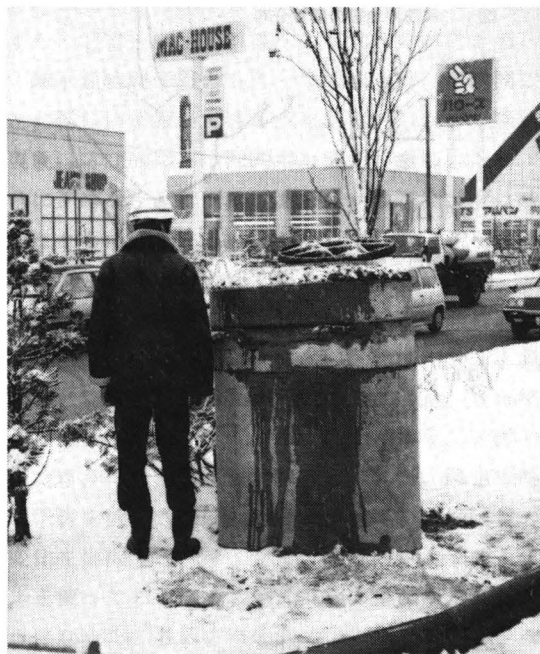
写真2 液状化による下水マンホールの浮き上がり
