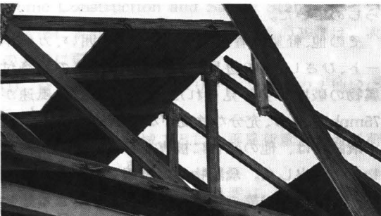
写真3 木造小屋組の被害3
