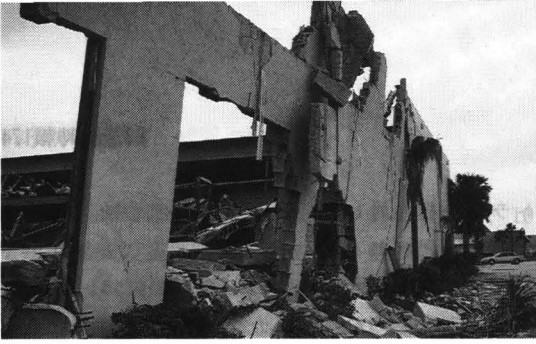
写真6 T型PC梁の落下に伴う商業建物の破壊
