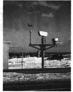
写真16 高速道路沿道の気象観測機器
