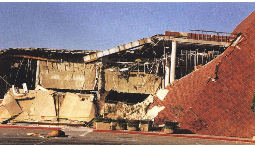
崩壊したショッピングセンター（ノースリッジ）
