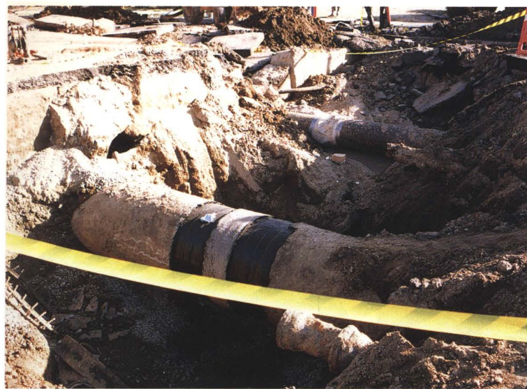
水道管（手前）とガス管（奥側）の被害現場（ノースリッジ）
