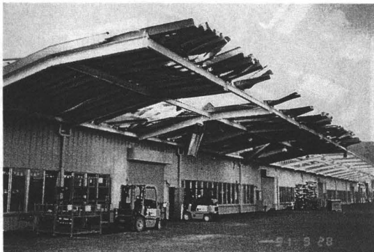
写真8 大ひさし折板の被害状況
