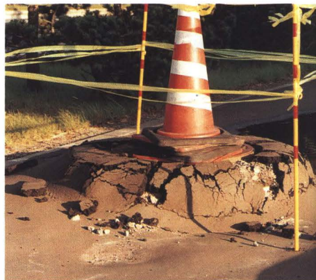
液状化で抜け上がったマンホール(釧路市) ／(社)日本損害保険協会
