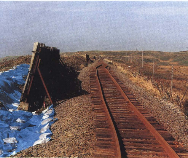
線路が歪み不通となった根室本線(落石-別当賀間) ／(社)日本損害保険協会
