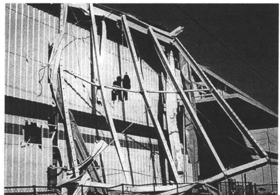
写真9 大破した大ひさし
