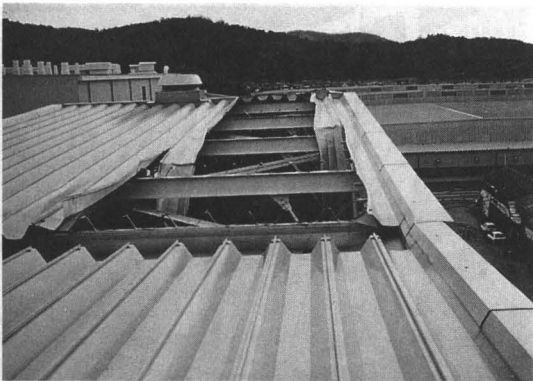
写真3 折板屋根の被害状況
