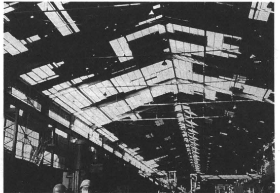
写真6 スレート屋根の破壊状況
