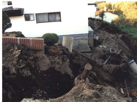
造成地の地盤が揺れて崩れて沈み、住宅が数十cm落ちた (中標津町)／(社)日本損害保険協会
