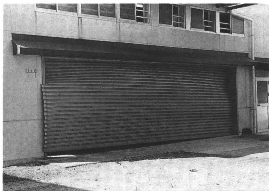
写真16 重量シャッターのスラットの抜け出し
