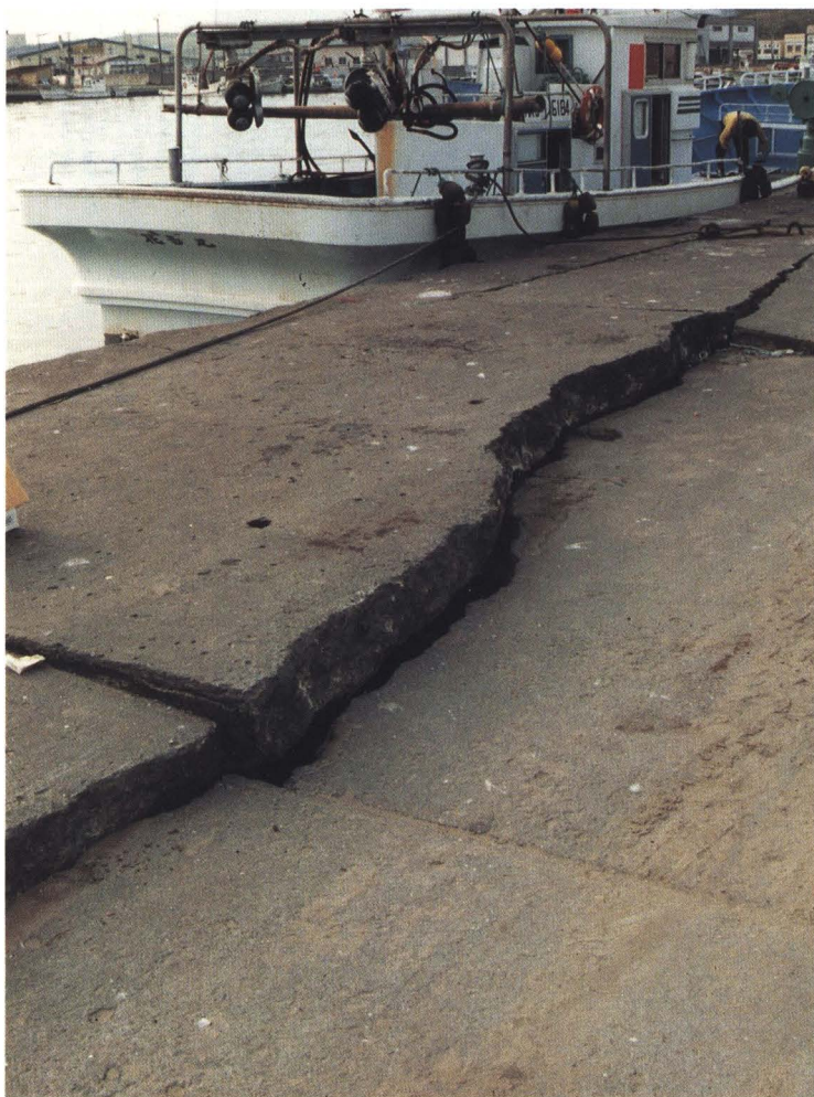
液状化により地盤が破壊された根室市の花咲港／(社)日本損害保険協会
