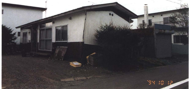
モルタル塗外壁が下地板ごと剥がれた住宅の壁。 モルタルが剥がれる被害は各地で見られた(根室 市)／(社)日本損害保険協会
