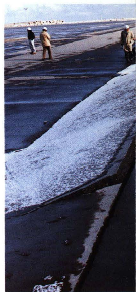
青森県八戸港の八太郎P岸壁の液状化被害/㊟
