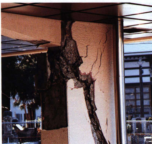
被害を受けて曲がった八戸東高校入り口付近の鉄筋コンクリート製の柱/㊟
