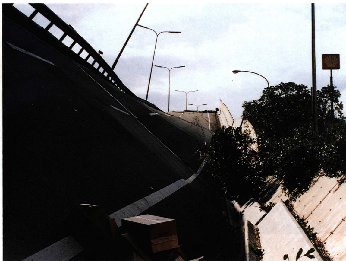
約635mにわたって横倒しになった阪神高速道路神戸線の倒壊現場／㊞
