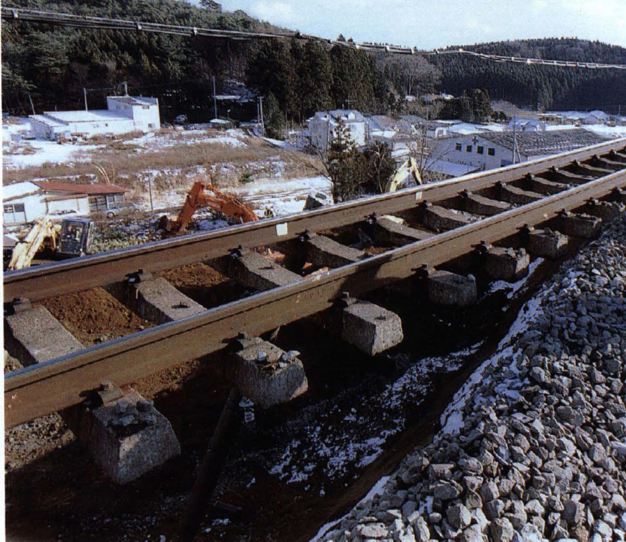
高さ約15mの盛土が長さ約30mにわたって崩壊した青森県八戸市のJR東北本線の八戸-陸奥市川/ロイター・サン
