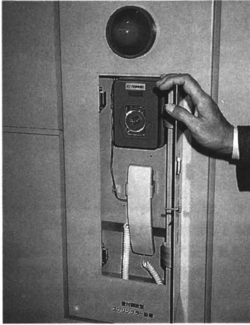
写真11 開放型スプリンクラーの操作ボックスとスイッチ
