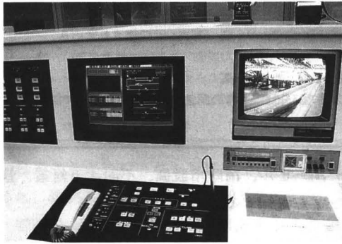
写真13 防災センター内の放水銃の監視、制御パネル 防災センター内において、3階と4階に設置された放水銃からのカメラ映像を監視し、火災の状況や周囲の安全を確認したうえで放水銃を遠隔起動させる。起動スイッチは常時ロックされており、起動操作時は、担当者が鍵でロックを解除する仕組み。
