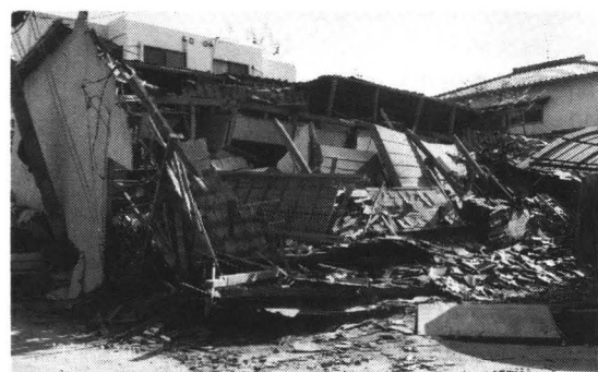
倒壊した木造住宅
