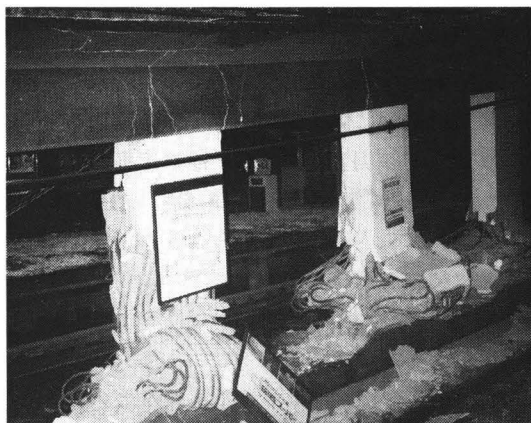
写真-4 地下鉄駅中柱の被害(地下)
