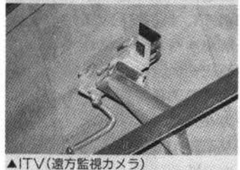
▲ITV (遠方監視カメラ)
