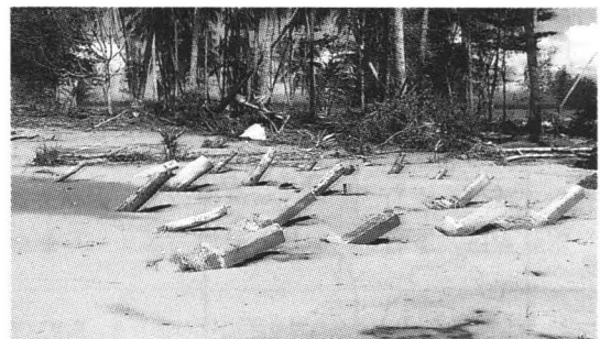
写真2-② 津波の後に残った建物の柱は右側の陸地に向かって傾いている
