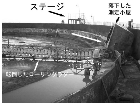
図12 地震後の30006原油タンク浮き屋根上の状況 (測定小屋とローリングラダーが落下)
