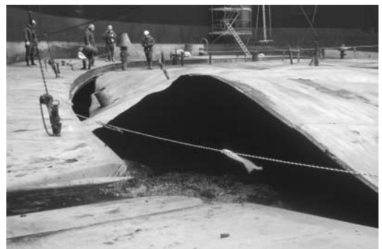
図8 100651原油タンクのデッキとポンツーンの溶接部の破断状況(デッキが破断長約33m)
