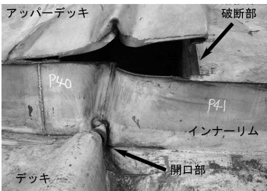
図9 100654原油タンクの西側のボンツーンの損傷
