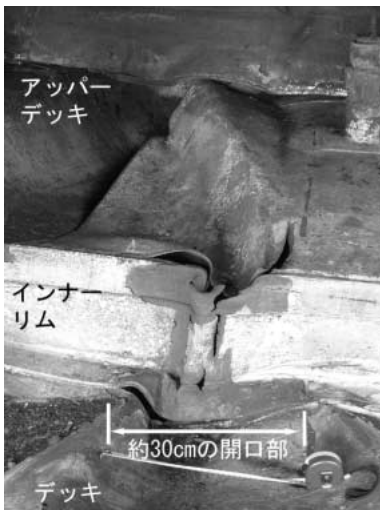
図11 30063ナフサタンクの18番ボンツーン(タンク北東方向)の損傷状況
