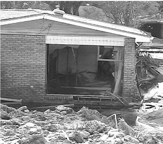
写真4 水が直撃した被災住宅
