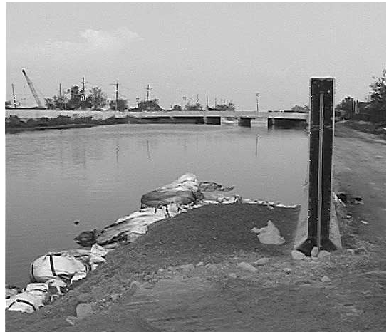
写真1 崩壊した堤防 - 1
