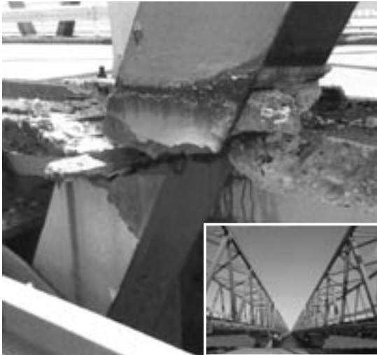
図8 2007年に起きた木曾川大橋の部材の破断
