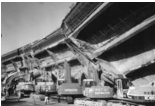
図2 1995年兵庫県南部地震での神戸市内高架橋の被害
