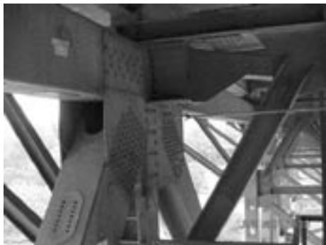
図7 橋の崩壊の起点となったと言われている U10 のガセットプレート（矢印）この写真は 2003 年撮影のもので、すでに板が曲がっていたことが分かる
