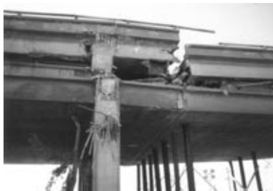
図1 1989年ロサンゼルス地震でのサンフランシスコ市内高架橋の被害
