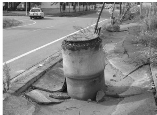
写真4 新潟県中越地震の際に液状化で浮き上がったマンホール
