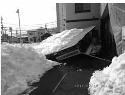
図7 倒壊した簡易駐車場(甲府市2/19)
