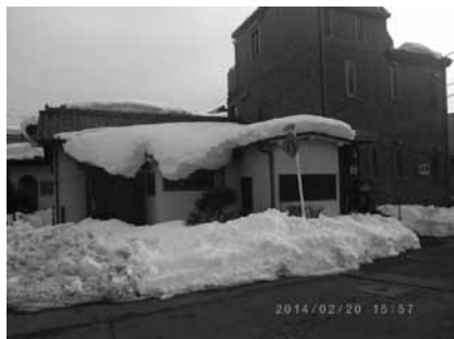
図8 危険な屋根雪の崩落(山梨県2/20)
